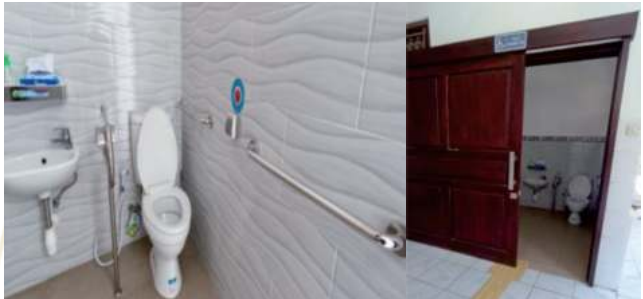
Gambar : Toilet disabilitas pada Pengadilan Negeri Singaraja
